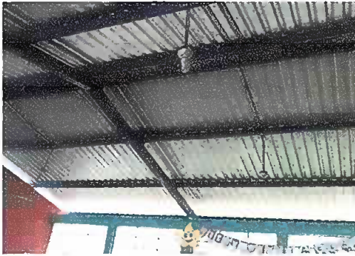
Foto 3. Módulo 1. Focos, se observa la colocación de los focos ahorradores en las aulas.
