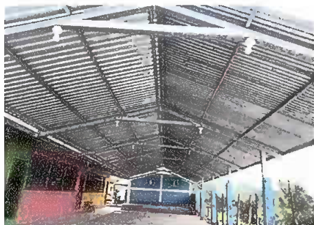
Foto 1. Módulo 4. Focos, se observa focos ahorradores en el patio.
