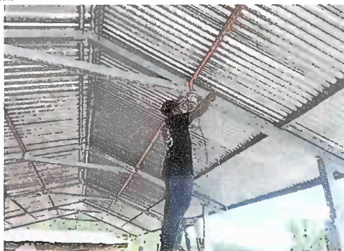
Foto 2. Módulo 4. Unidad de luz, se observa la instalación del cableado eléctrico por el electricista.
