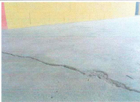
Foto 3: Módulo 1. Patio, se observa el piso agrietada en su totalidad y requiere mantenimiento.
