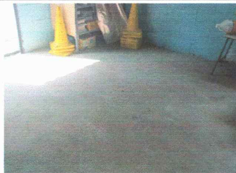
Foto 4: Modulo 2. Piso, se observa el piso de dirección que requiere mantenimiento en su totalidad.
