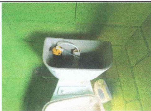
Foto 5: Modulo 3. Inodoro, se observa que esta sin uso el tanque por fisura.
