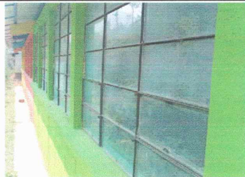
Foto 2: Modulo 1. Ventana, se observan las ventanas expuestas a cualquier golpe o robo, por seguridad requiere instalación de balcones.
