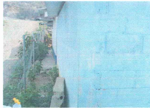
Foto 16: Pintura General. Dirección y cocina en su exterior requiere pintura .
