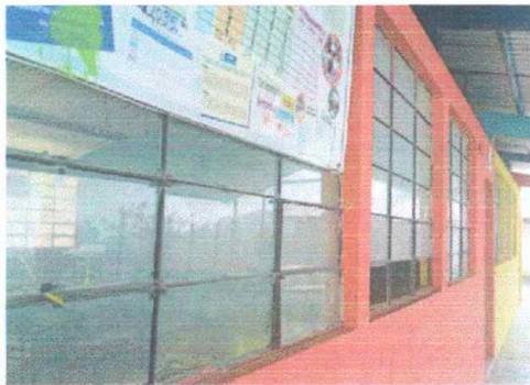
Foto 1: Modulo 1. Ventana, se observan tres vidrios rotos, lo cual presenta inseguridad, requiere instalación de vidrios y balcones.
