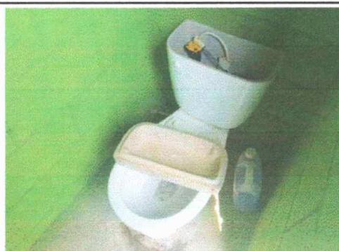
Foto 6: Modulo 3. Piso de Inodoro se colapsó y requiere de mantenimiento y sustitución.
