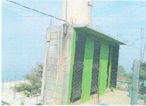
Foto 13: Patio. Depósito de agua, se observa el depósito de agua de 1,100 It en uso exclusivamente para baños por su ubicación.
