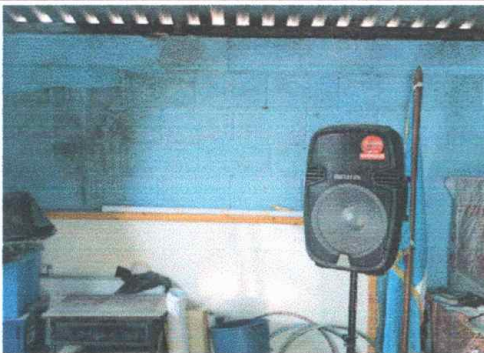
Foto 17: Pintura General. Se observa pared dirección interior requiere pintura en su totalidad.
