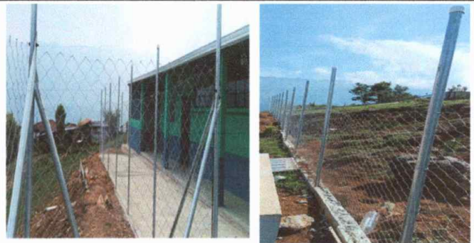
Foto 6: Circulación del establecimiento necesita tensores.
