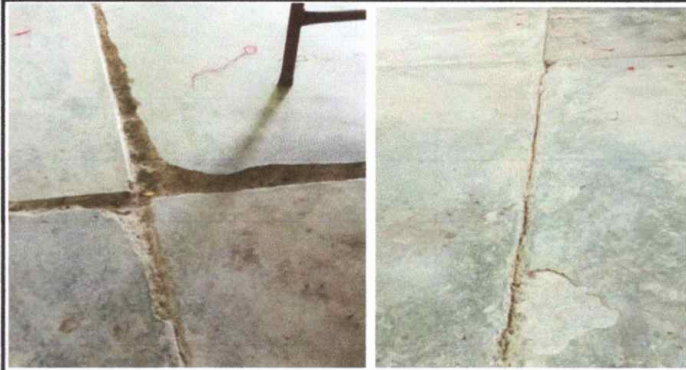
Foto 1: MODULO 1 Torta de concreto en mal estado, por cerámico
