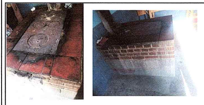
Módulo 2: Sustitución de plancha de metal, instalación de azulejo y piso cerámico.
