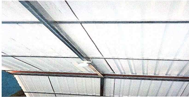
Foto 13. Módulo 2: Finalización de sustitución de estructura de soporte de metal por metal.
