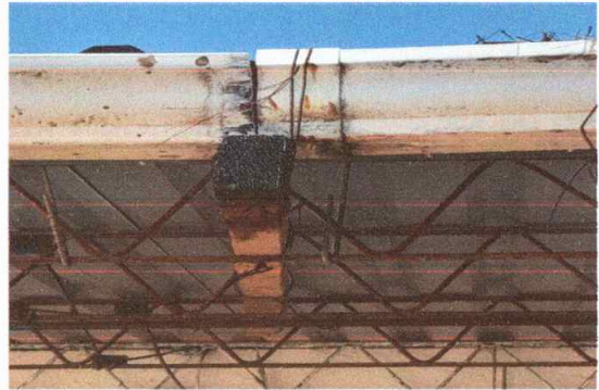
Foto 2: Renglon 3. Modulo 1 Sustitución de soporte o pescante de metal para canal
