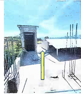
Foto 2: Construcción de pasillo de terraza para unir la terraza de las aulas, la de los baños y el tinaco de agua.
