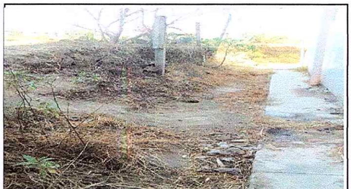
Foto 8.2: CUNETA DE CONCRETO. Reparación de banquetas de concreto. Dañada por erosión y filtración de agua fluvial en las aulas, en época de invierno.
