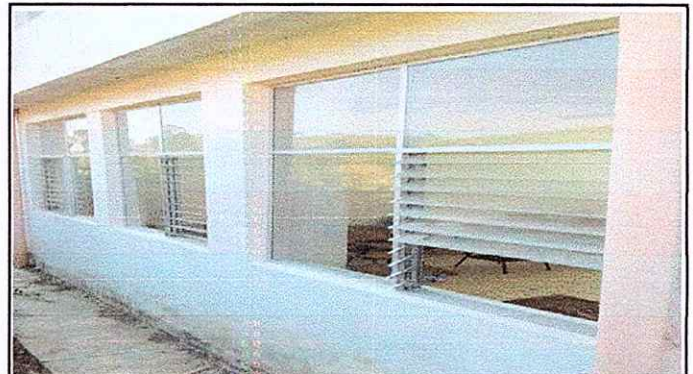
Foto 5.5: Sustitución y cambio de vidrios en su totalidad. Ya que la mayor parte esta dañada.
