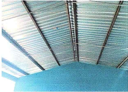
Foto No. 7, Módulo No. 2. Sustitución de lámina, por lámina troquelada aluzinc calibre 26, desinstalación de lámina.
