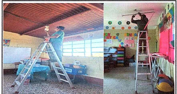
Foto 4: Modulo 2. Sustitución de focos ahorradores y sustitución de lamparas tipo led.
