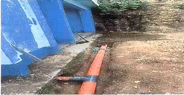
FOTO 15 MODULO 3 TUBERÍA PVC Y ACCESORIOS
