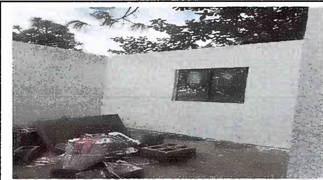
FOTO 3 MODULO 1 CERNIDO EN MURO REPELLO Y
