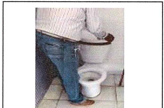
Foto 12: Sustrucción de accesorios de inodoros
