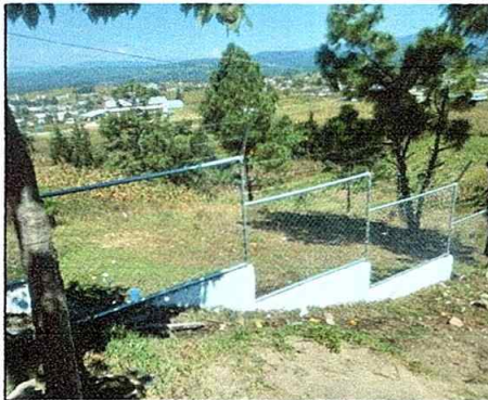
Foto 6: Reparación de muro perimetral con tubo hg y malla galvanizada, soleras intermedias y columnas, pintura
