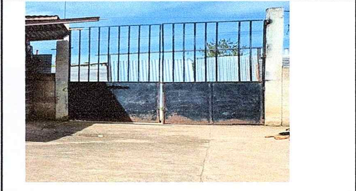
Foto 20: MURO PERIMETRAL se muestra el mal estado del portn de entrada el cual sera sustituido
