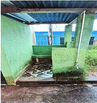
Foto 13: MODULO 3 se muestra el mingitorio donde es necesario colocarle una puerta y cubrir las paredes con block
