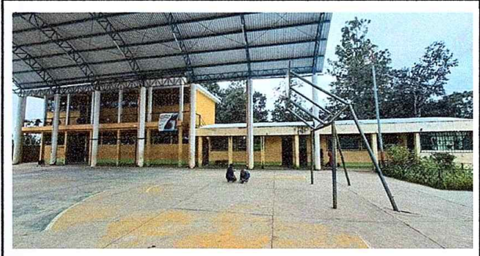
Foto 22: PINTURA GENERAL fotografia donde se muestra el mal estado de la pintura por lo que se pintara de nuevo
