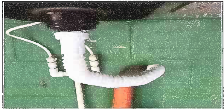
Foto 4: SUSTITUCION DE MEZCLADORA DE LAVAMANOS (SIFON FLEXIBLE)
