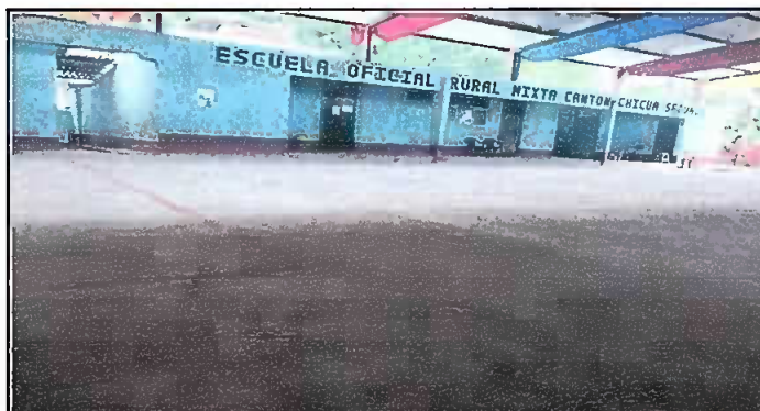
Foto 4: Enfrente de aula de Sexto A, reparación de plancha de concreto de patio.
