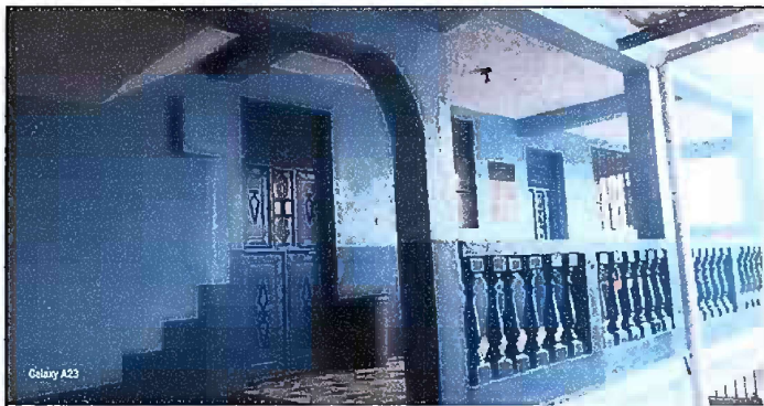
Foto 5: Módulo 2 (Planta alta y baja)- Mantenimiento a estructura de puerta (lijado, cambio de tubo, cepillado, sujeciones, aplicación de pintura).
