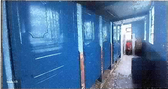
Foto 2: Módulo 1 (Planta baja y alta) - Mantenimiento a estructura de puerta (lijado, cambio de tubo, cepillado, sujeciones, aplicación de pintura).
