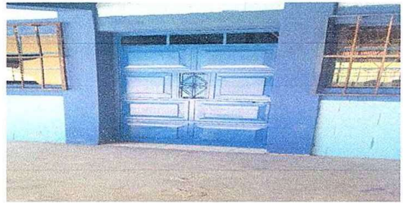
Foto 10: Modulo2. Mantenimiento a estructura de puerta (lijado, cambio de tubo, cepillado, sijecciones, aplicación de pintura)
