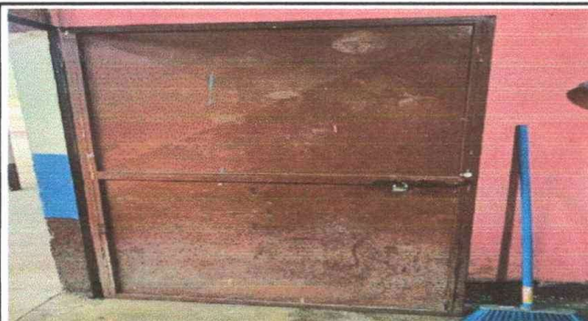
Foto 11, Modulo 1: Mantenimiento a estructura de puerta (lijado, cambio de tubo, cepillado,sujeciones, aplicación de pintura)
