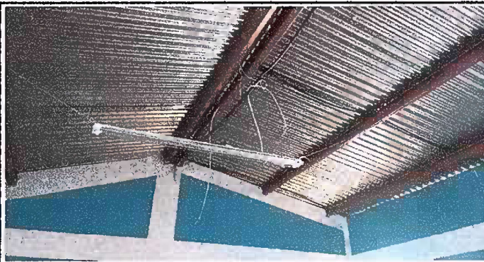
Foto 1: Modulo 1 Situación de lamparas
