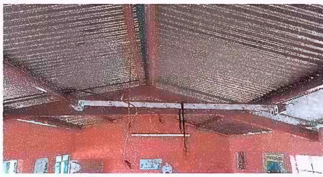
Foto 1: Modulo 1 Situación de lamparas
