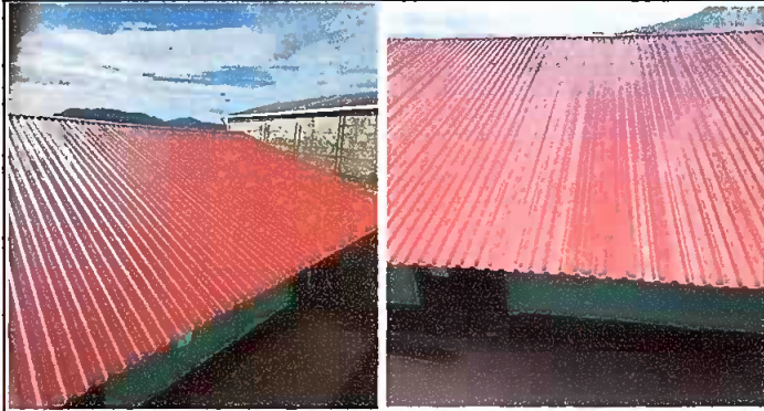
Fotografía 1. MODULO 1: Sustitución de lámina (duralita) capote y elementos de fijación (tornillos) por lámina troquelada.
