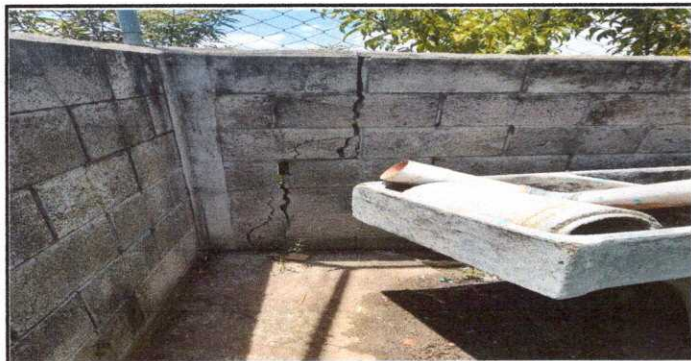
Fotografía 11. MURO PERIMETRAL: Reparación de muro perimetral de block con Tubo hg y malla galvanizada, soleras intermedias y columnas
