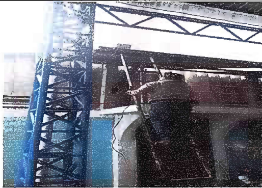
Foto No. 9 MODULO 5 Sustitución de canal de metal y sustitución de soporte de metal para canal.
