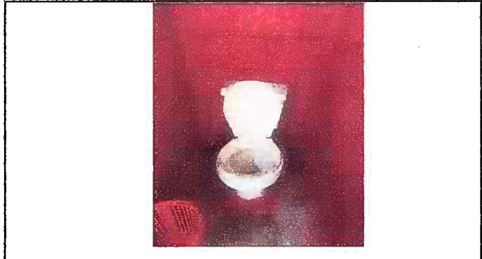
Foto 26 Módulo 6: Sustrucción de inodoro.
