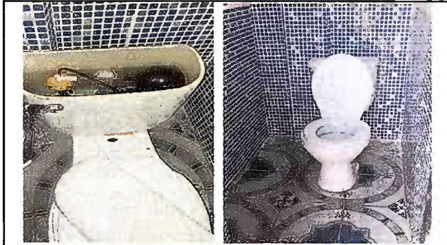
Foto 1, Módulo 1: sustitución de accesorios inodoro (contra llave, tubo de abasto y tanque)
