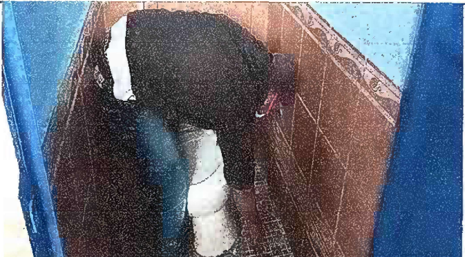
Foto 12: Sustrucción de taza de baño
