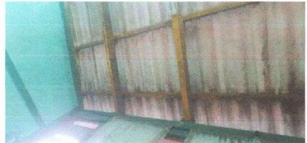
Foto 2: Modulo 1. Sustitución de lámina, por lámina troquelada aluzinc calibre 26, desinstalación de lámina existente
