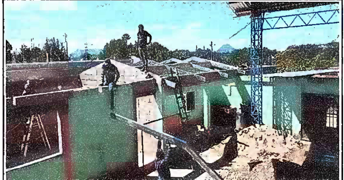
Foto 2: Módulo 1. Durante el proceso se está haciendo la colocación de tubo estructural galvanizado.
