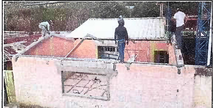
Foto 6: Módulo 2. Durante el proceso se está haciendo la colocación de tubo estructural galvanizado.
