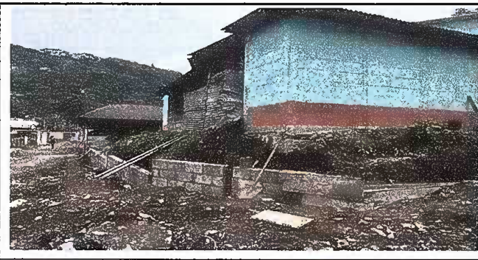
Foto5: MURO PERIMETRAL. Reparación de muro perimetral de blok con tuvo HG, malla galvanizada, soleras intermedia y columnas de sostenimiento
