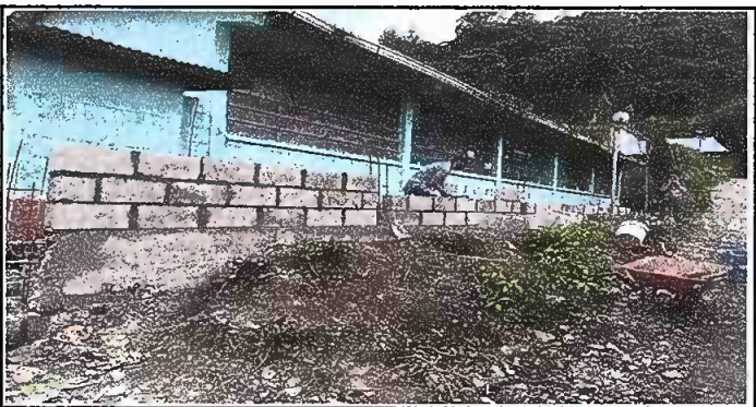
Foto6: MURO PERIMETRAL. Reparación de muro perimetral de blok con tuvo HG, malla galvanizada, soleras intermedia y columnas de sostenimiento
