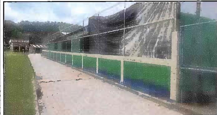
FOTO NO. 5 MURO PERIMETRAL: Reparación de muro perimetral con tubo hg y electromalla
