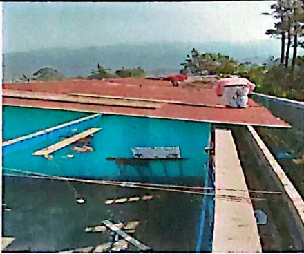
Foto 1: empiezan el desprendimiento de las laminas viejas
