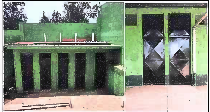
Foto 4: Mantenimiento a estructura metal (lijado, sepillado, sujeciones, aplicación de pintura) a 10 puertas de salones de clases y baños
