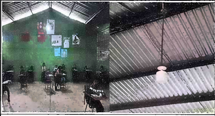
Foto 5: Sustitución (cableado, bombillas led, tomacorrientes y apagadores electricos) y mejoramiento de la red electrica en 4 aulas, direcciones y patios.
