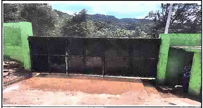
Foto 6: Mantenimiento a estructura metal (lijado, sepillado, sujeciones, aplicación de pintura) al porton de acceso a entrada del establecimiento
