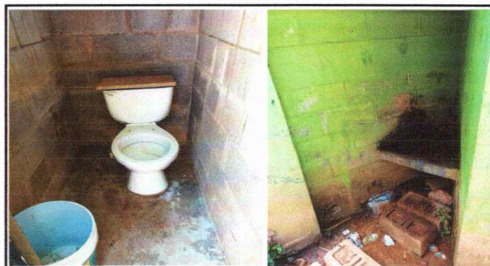
Foto 4: Sustitución de inodoros y accesorios para inodoros (Contra llave, tubo de abasto), Instalación de un lavamos o pileta.
