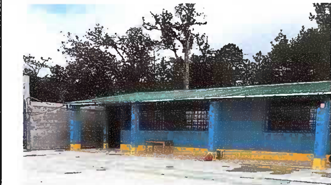
Foto1: Cambio de lámina, por lámina troquealada aluzinc calibre 26
