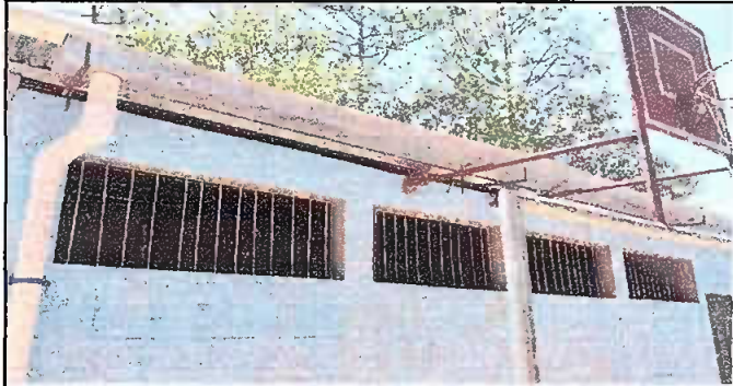
Foto 5: Instalación de canales de metal y colocación de bajadas de agua pluvial en techado de cocina y bodega. Y elementos de fijación. Módulo 5.
