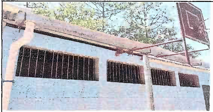
Foto 5: Instalación de canales de metal y colocación de bajadas de agua pluvial en techado de cocina y bodega. Y elementos de fijación. Módulo 5.
