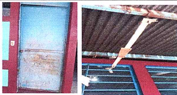
Foto 3: Mantenimiento a estructura (aplicación de pintura) puertas de las aulas y instalación de accesorios electricos.
