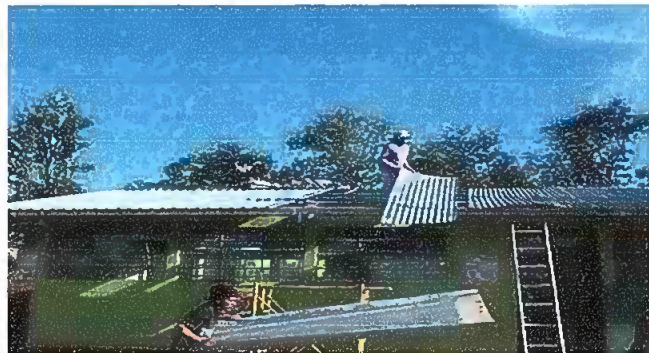
Foto 3: MODULO 1. Se procede a sustituir los capotes y los elementos de fijacion.
