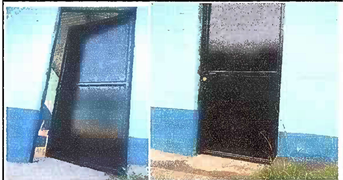
FOTO 8. MÓDULO 2: Mantenimiento a estructura de puerta (lijado, cambio de tubo, cepillado, sujeciones y aplicación de pintura). Reajuste de puerta.
