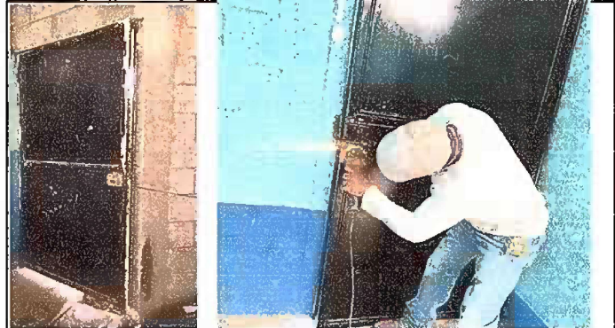
FOTO 20. MÓDULO 5: Mantenimiento a estructura de puerta (lijado, cambio de tubo, cepillado, sujeciones y aplicación de pintura). Reajuste de puerta.
