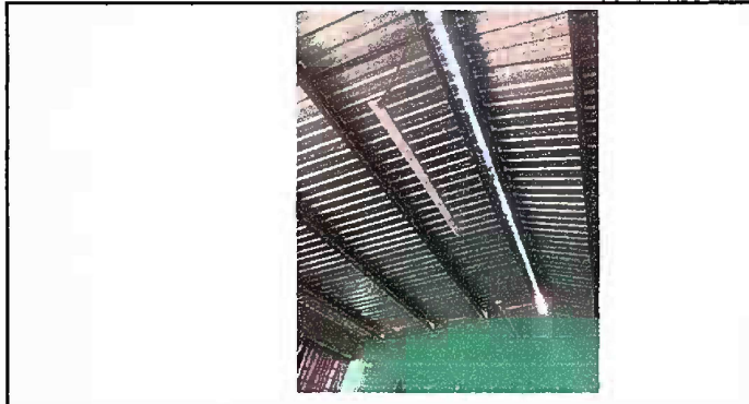
Foto 2: Modulo 1 Sustitución de capote de lámina para lámina troquelada, sustitución de elementos de fijación (tornillos).
