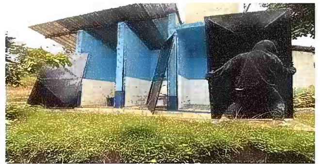
Foto 5: Modulo 3, mantenimiento de estructura de puerta (lijado, cambio de tubo, cepillado, sujeciones, aplicación de pintura) servicios sanitarios
