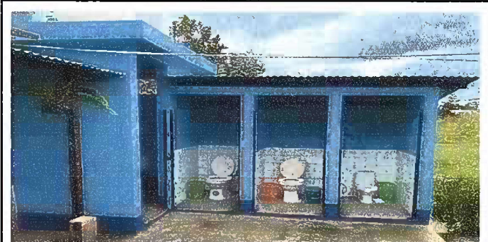
Foto 6: Modulo 2, mantenimiento de estructura de puerta (lijado, cambio de tubo, cepillado, sujeciones, aplicación de pintura) puertas servicios sanitarios
