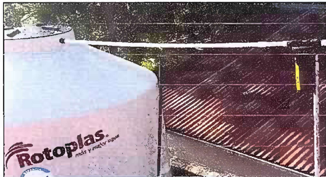
Foto 9: Esta foto es del Módulo 4 de sustitución de depósito de agua, REPARACIÓN Y MANTENIMIENTO DE CISTERNAS / DEPÓSITO DE AGUA. FASE FINAL
