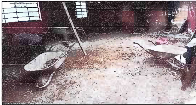
Foto 5: Esta foto es del Módulo 2 de sustitución de piso de torta de concreto, PISO, fase de trabajo
