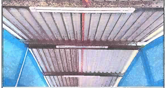
Foto 14: Modulo 3 Sustitución de lamparas tipo LED, Instalación de unidades luz (incluye interruptor, ducto y cable eléctrico)
