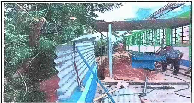
Foto 20: MODULO 6 Reparación de muro perimetral de block con tubo hg y malla galvanizada, soleras intermedias y columnas.
