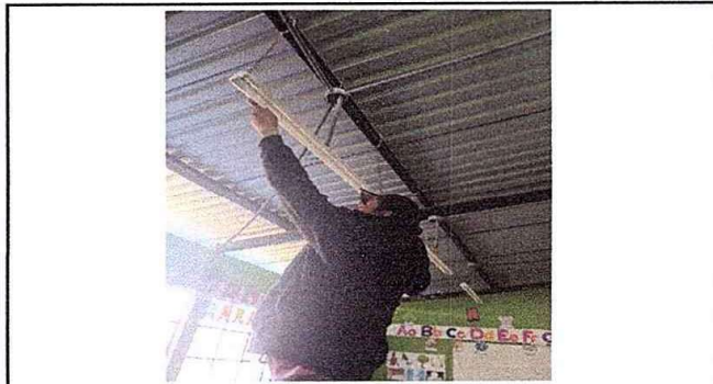
Foto 3: Módulo 1. Sustitución de lámparas led.
