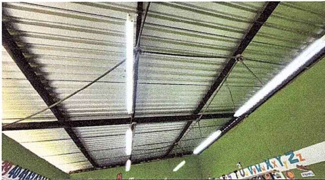
Foto 3: Módulo 1. Sustitución de lámparas led.
