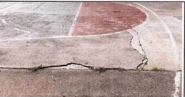
Foto 5: Cancha polideportiva. Torta de concreto
