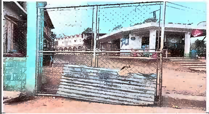
Foto 2: Se Requiere de sustitución de portón
